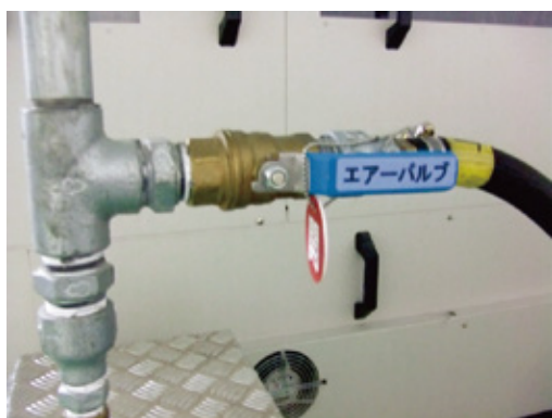
エアバルブ開（設備稼働時）
