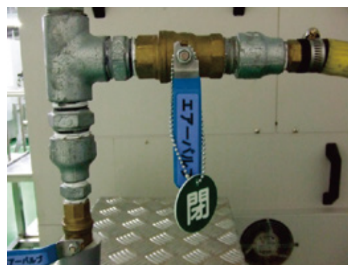
エアバルブ閉（設備非稼働時）
