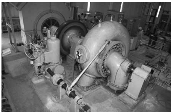
盛岡発電所の発電機
