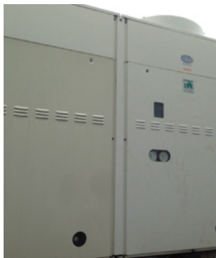
カートクーラー室外機
