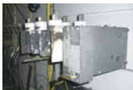
焼損したVCB
