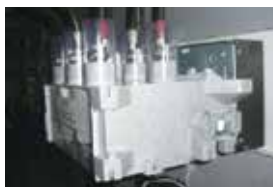
取替後のVCB
