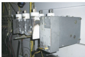
焼損したVCB
